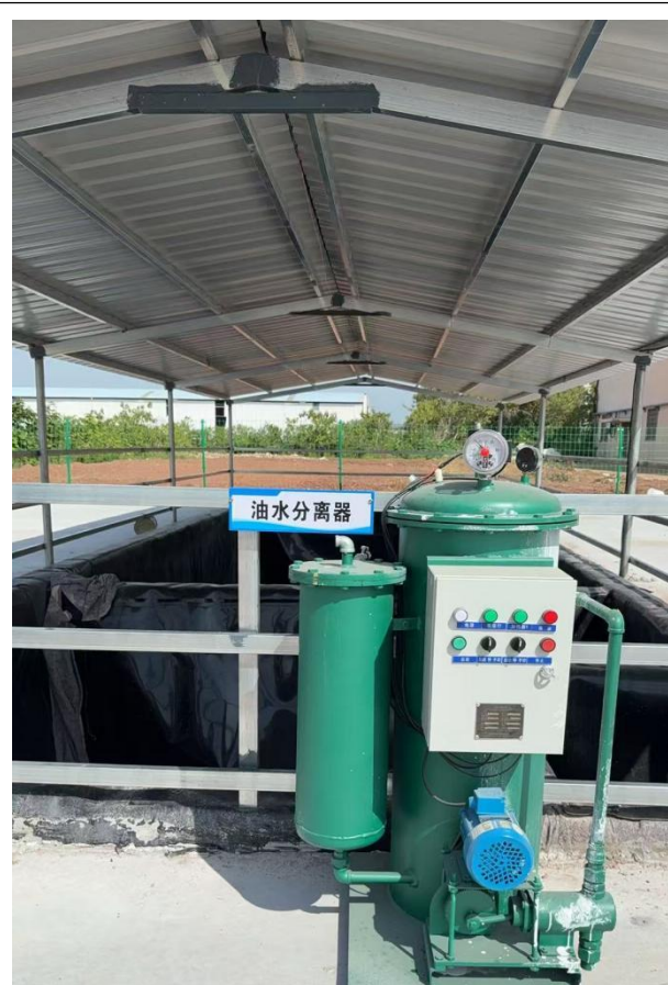
初期雨水池及油水分离器
