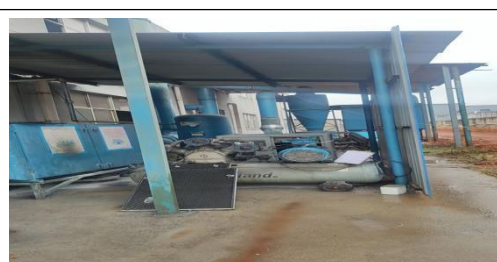
废气处理设施
