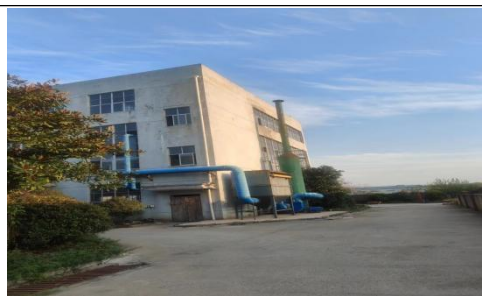
DA001 废气排放口
